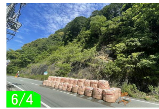
6/4 法面崩落調査(飯高町下滝野)
