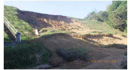
10/26 台風被害調査 伊勢寺町向側池
