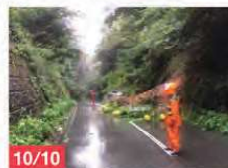
10/10 根木峠の法面崩壊調査 (御麻生園町地内)
